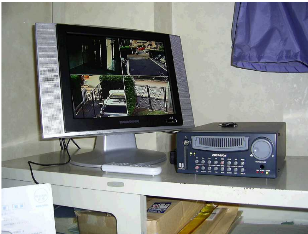
管理室内に録画機器 (DVR) 及びモニター監視
